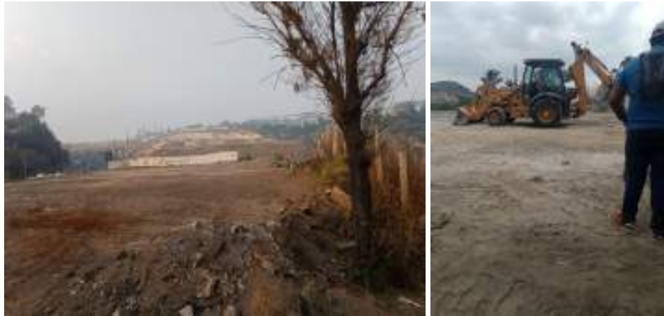
Fotos 1 y 2: Movimiento ilegal de tierras denunciado.
