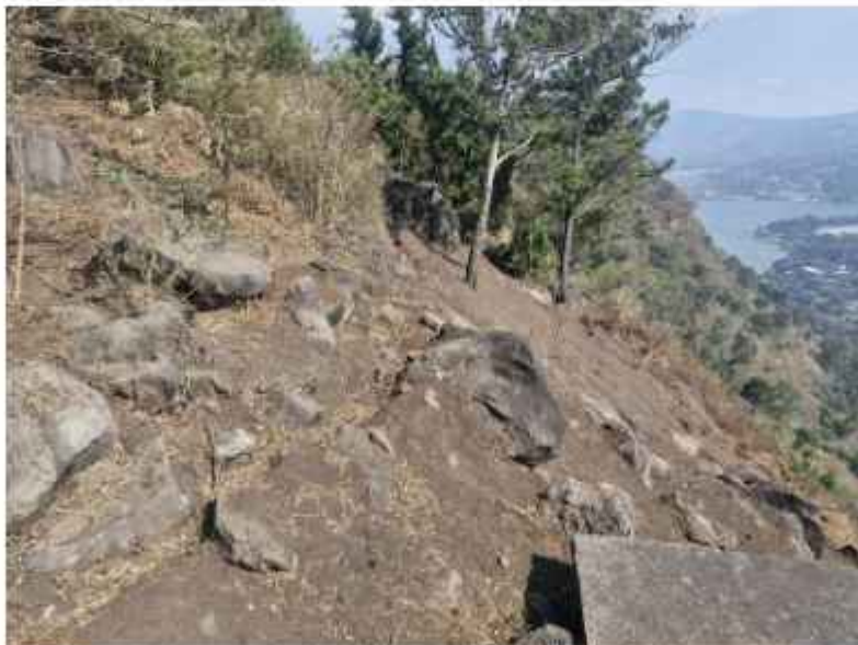
Foto 8: Estado actual de acequias en reduciendo erosión en brechas cortafuego
